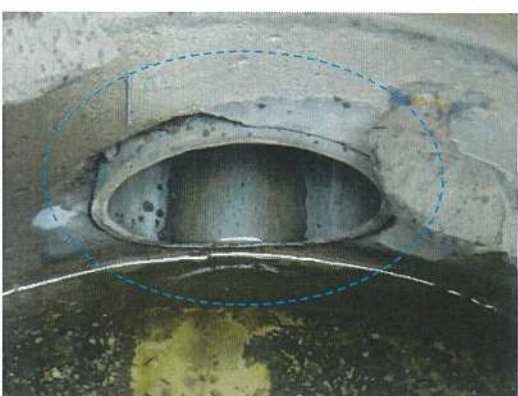
雨水桝-63 桝劣化破損近景
