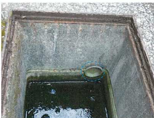
雨水桝-◇C◇ 桝劣化破損状況
