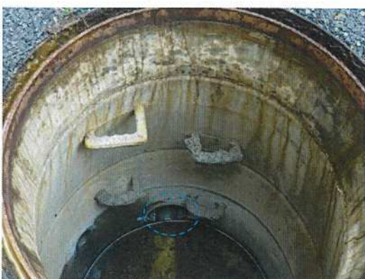
雨水桝-63 桝劣化破損状況
