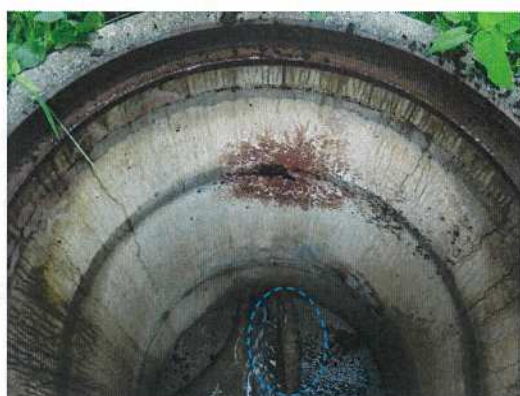
汚水桝-②④ 桝劣化破損状況
