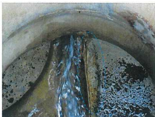
汚水桝-②④ 桝劣化破損近景
