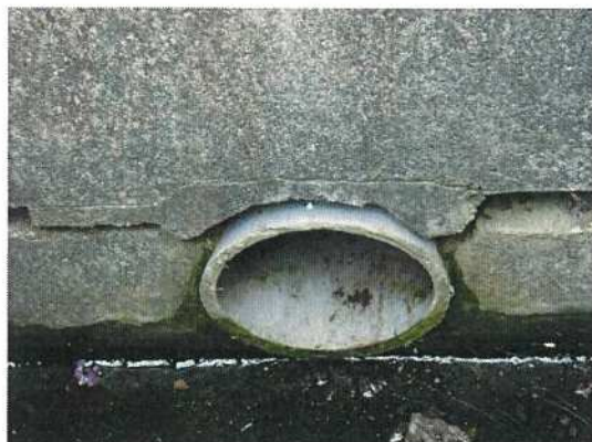
写真 2-1 樹劣化破損状況
