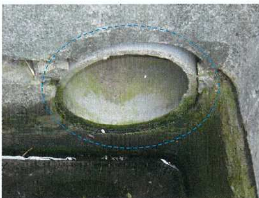
雨水桝-◇C◇ 桝劣化破損近景
